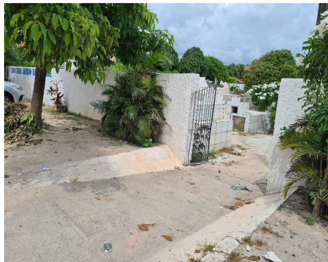
Figura 2. Calçamento externo implantado com nível inferior a rua principal da região, e um túmulo implantado no muro do Cemitério Jardim da Saudade, Tamandaré/PE
