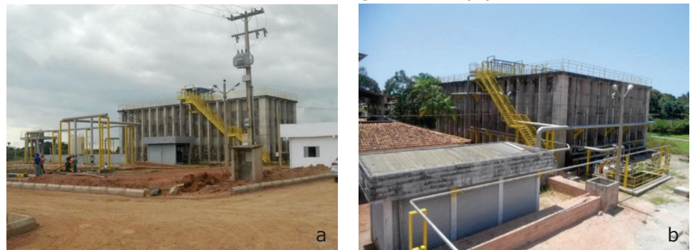
Figura 6. Estação de Tratamento de Esgoto Urumari (A) Estação de tratamento de Esgoto Irurá (B).
